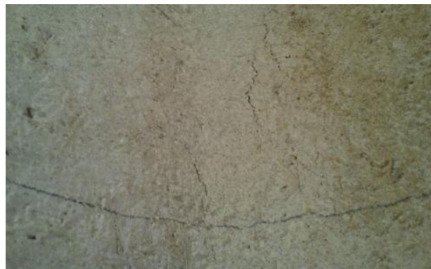
Fissures au niveau de l'angle arrondi non tramé
