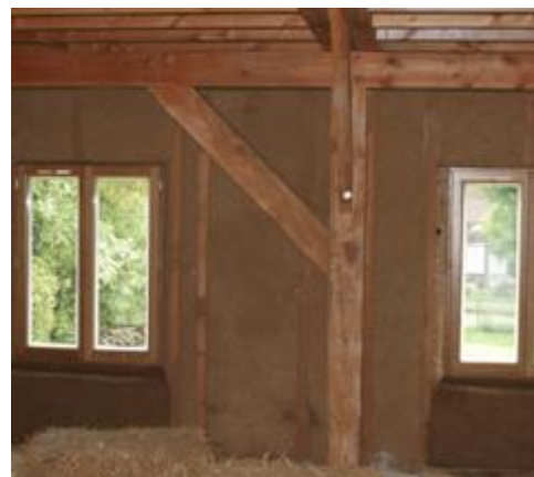
Difficulté de réaliser un enduit intérieur derrière une ossature bois intérieure ( http://www.canousbotte.net )
