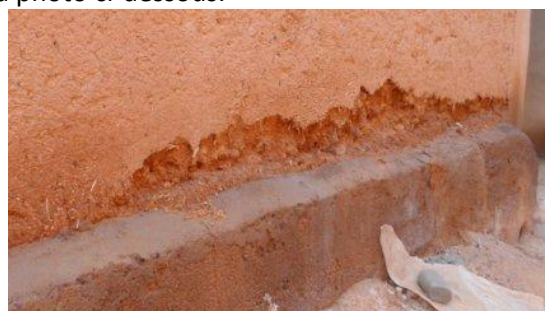
Enduit lessivé par les projections d'eau sur l'enduit ciment (Nekob, Maroc)
