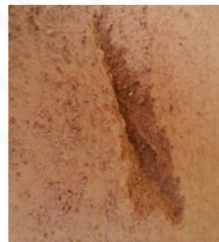
Accroc dans un enduit, au niveau d'un angle sortant arrondi
