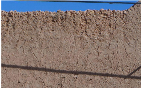
Mur non capé érodé + enduit fissuré (Ouled Driss, Maroc)
