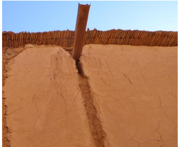
Évacuation ne remplissant plus son rôle, enduit et mur endommagé (Agdes, Maroc)
