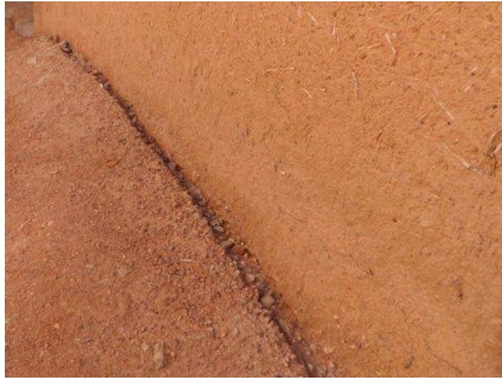
Trace de l'eau tombant depuis la couverture d'un mur refait récemment (Nekob, Maroc)
