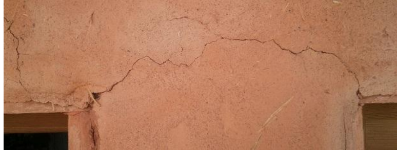
Fissures partant des linteaux (enduit non tramé)
