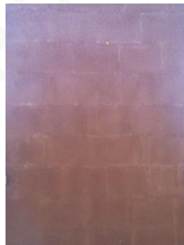
Spectres visibles sur un enduit sec (support terre cuite)
