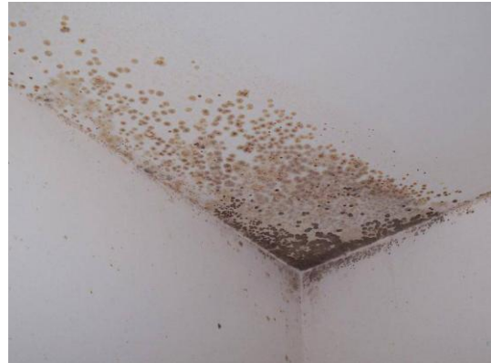
Moissures dans un angle de mur, au niveau d'un pont thermique, induit par une surchauffe et une mauvaise ventilation de la pièce
