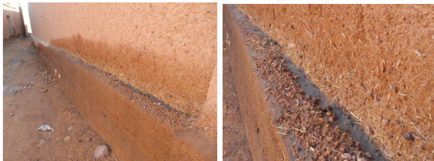
Protection de pied de mur inefficace (Nekob, Maroc)
