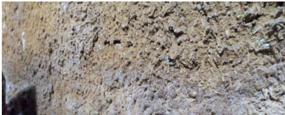
Salpêtre apparu sur un enduit terre (mur en pierres hourdées à la terre), dans les zones en permanence humides
