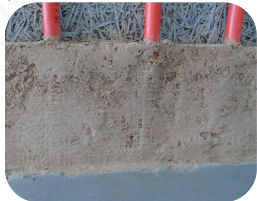
Mur chauffant sur Fibralith (grands ateliers de Villefontaine, 2013)
