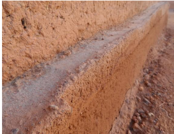
Absence de pente sur l'enduit de protection en ciment (Nekob, Maroc)
