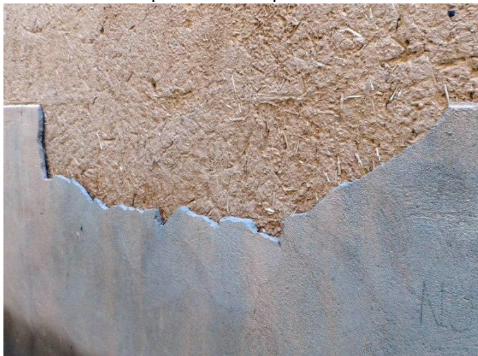
Enduit ciment décollé, sur enduit terre extérieur (Nekob, Maroc)
