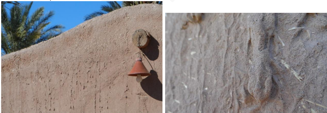
Terre/sable lessivé par la pluie sur enduit extérieur très sableux (Tagounite, Maroc)
