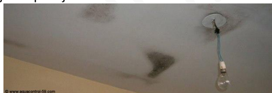
Traces de condensation en plafond
