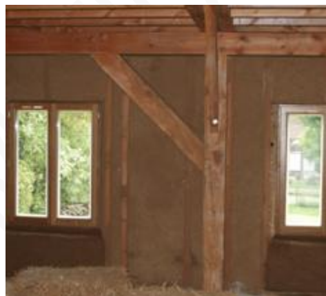
Difficulté de réaliser l'étanchéité à l'air derrière une ossature bois intérieure ( http://www.canousbotte.net )
