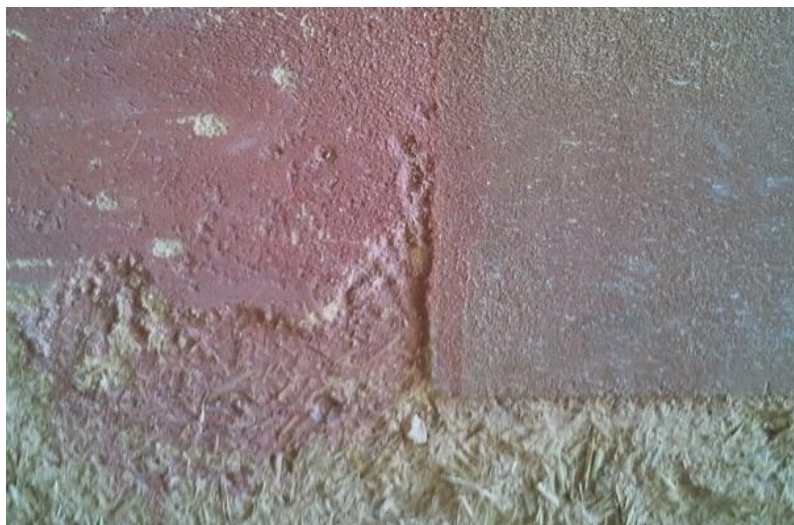
Enduit en bas de mur soumis à projection d'eau, 2 couches d'huiles de lin passées au pinceau (à droite), sans traitement de surface (à gauche, 2 couches de lait passées à gauche pour arrêter la dégradation)
