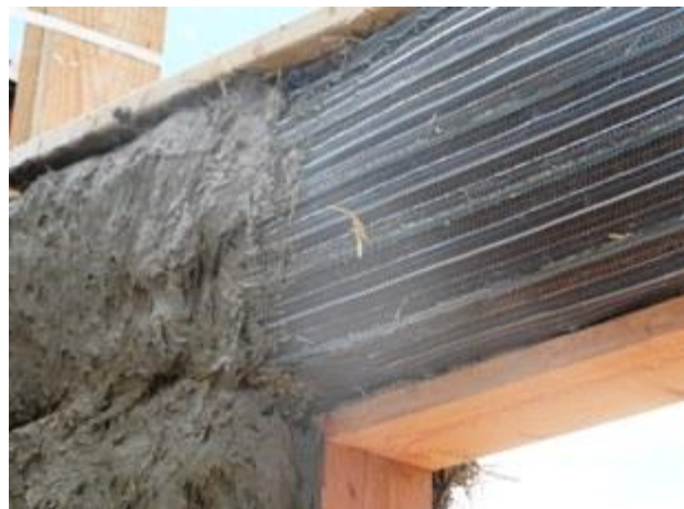
Nergalto au dessus d'un linteau de fenêtre
