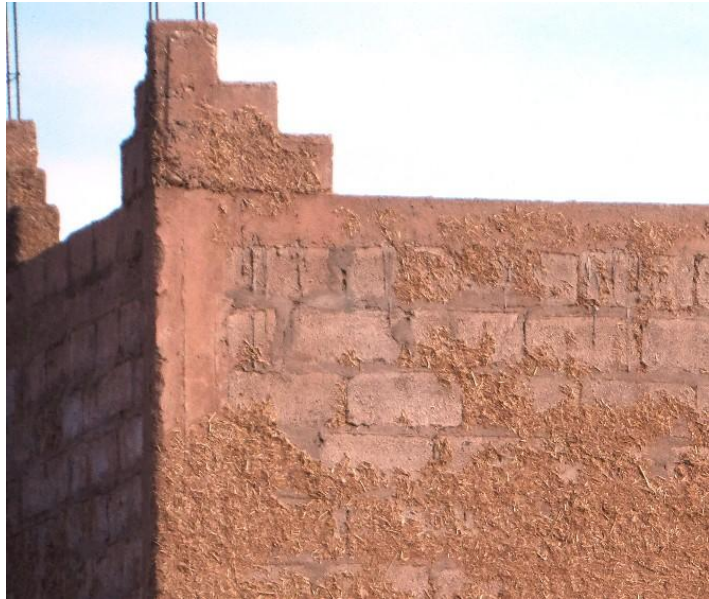
Enduit terre lessivé par les pluies (Mhamid, Maroc)
