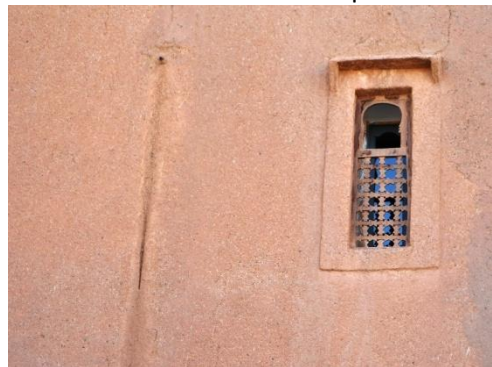
Trace du trop plein d'un cumulus ou d'une climatisation (Tamnougalt, Maroc)
