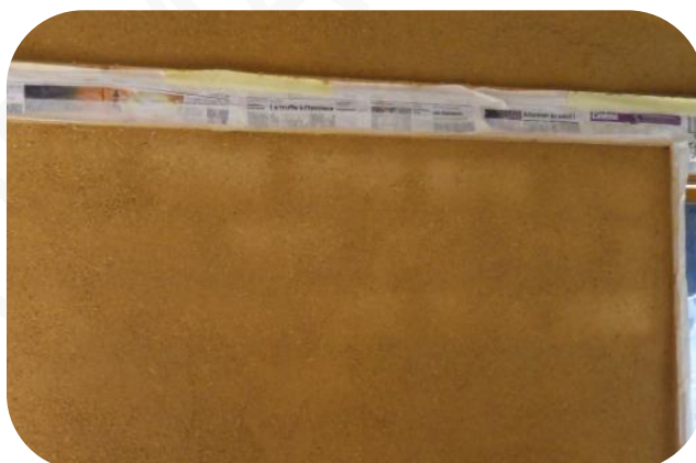
Séchage hétérogène du corps d'enduit sur briques de terre crue extrudées (pas de couche d'accrochage, spectre visible après ½ journée)
