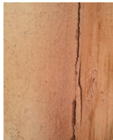
Liaison enduit/bois mal gérée
