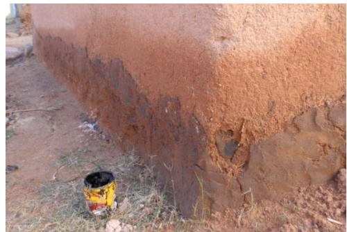
Bricolage inefficace au ciment en pied de mur (Nekob, Maroc)
