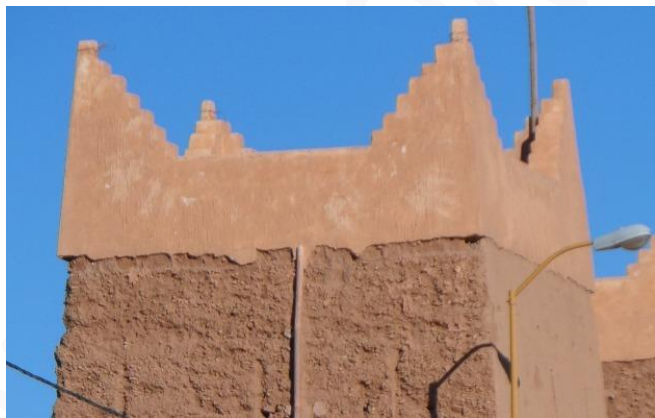
Érosion sous un accrotère enduit au ciment (Tagounite, Maroc)
