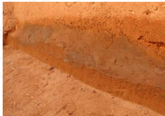
Bricolage improvisé - enduit ciment sur l'enduit de protection (Nekob, Maroc)
