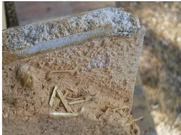
Enduit terre sur placo, avec couche d'accroche, non décollé suite à une chute
