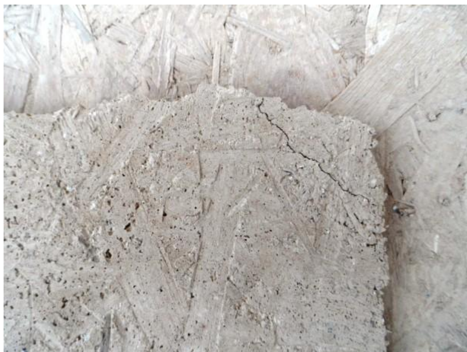
Empreinte de l'OSB sur l'enduit de corps (accroche insuffisante)
