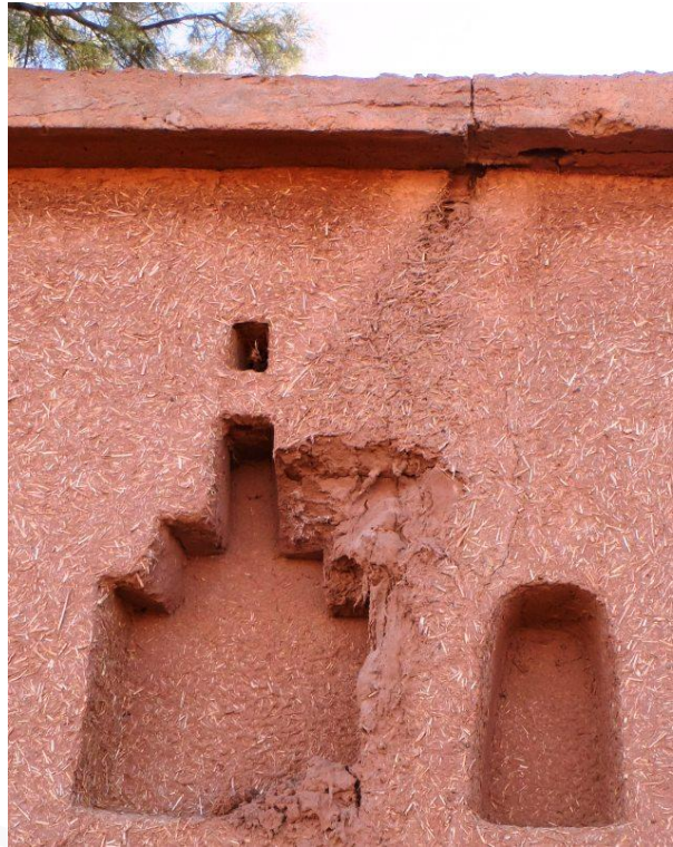
Détérioration des niches / fuite dans l'accrotère (Mhamid, Maroc)
