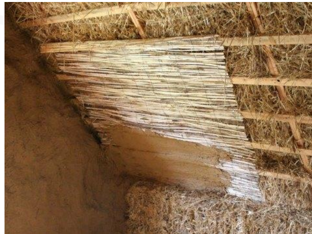
Canisse sur amature (trop ?) légère montée sous les rampants d'une toiture
