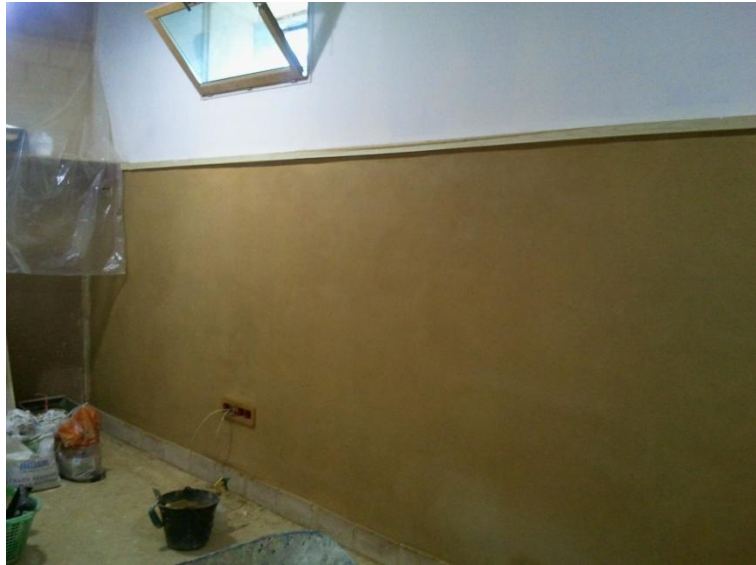
Enduit terre intérieur / mur chauffant sur structure bois-paillasons isolée en balle de riz, Maison Commune Cavaillon, mise en œuvre Le Village - APTE, 2014
